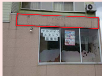
落下した後の壁面
