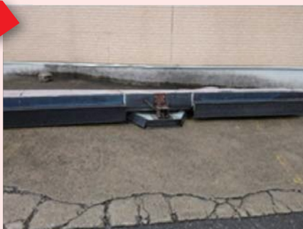
落下した欄間看板
