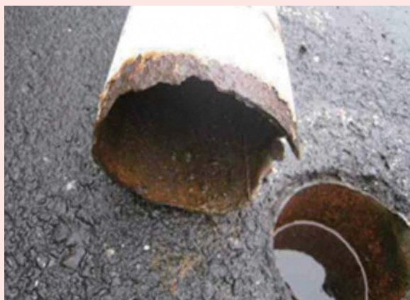
ポールの根腐れによる倒壊
