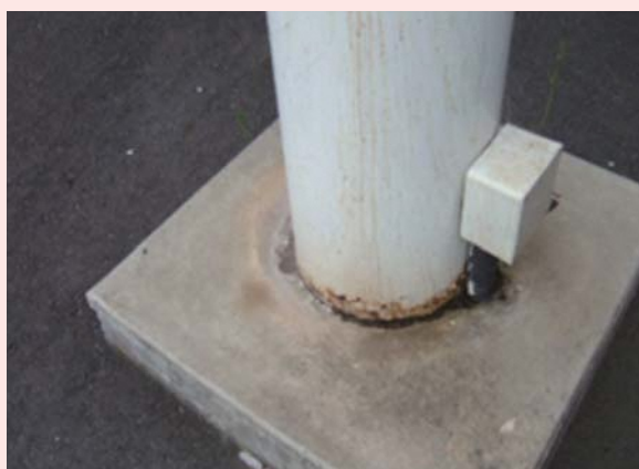
ポールの根元にサビが発生
