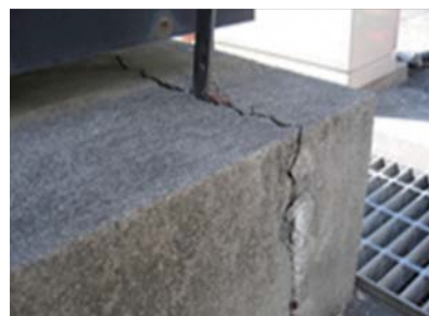
看板基礎のひび割れ
