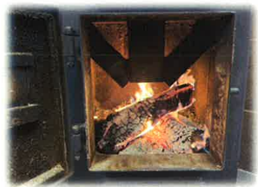
薪ストーブの様子
